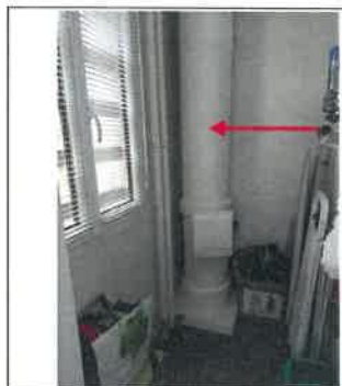
Photo n° PhA001 Localisation : buanderie Ouvrage : Conduits de fluides (air, eau, autres fluides) Partie d'ouvrage : Conduits Description : Conduits
