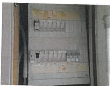
Photo du Compteur électrique
