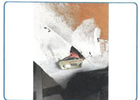
Anomalie B.7.3 a sur Install. n°1
