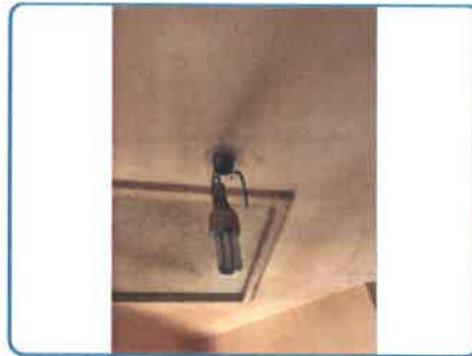
Anomalie B.3.3.6 a3 sur Install. n°1
