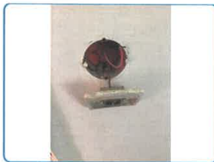
Anomalie B.8.3 e sur Install. n°1
