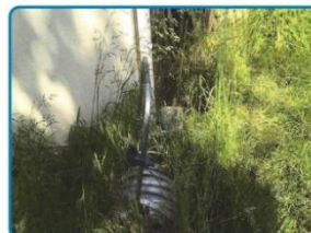
Gouttière 2 avec regard sur puisard
