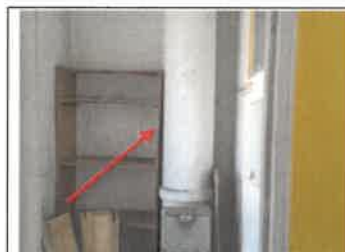
Photo n° PhA001 Localisation : Séchoir Ouvrage : 3. Conduits, canalisations et équipements intérieurs - Conduits de fluides (air, eau, autres fluides) Partie d'ouvrage : Conduits Description : Conduits
